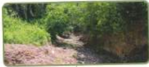
Les travaux d'entretien réalisés sur la Cassole (commune de Cotignac) ont permis de restaurer la capacité hydraulique du cours d'eau.
