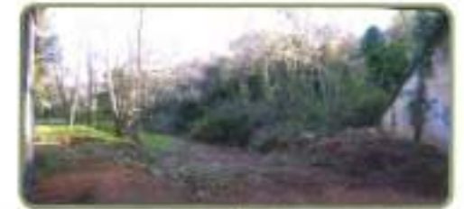
Sur le bassin du Blavet jusque-là, "orphelin", les travaux réalisés en 2022, conformément au PPRE, ont permis de rattraper une importante carence d'entretien.
